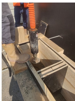
5 Dammage avec fouloire pneumatique
