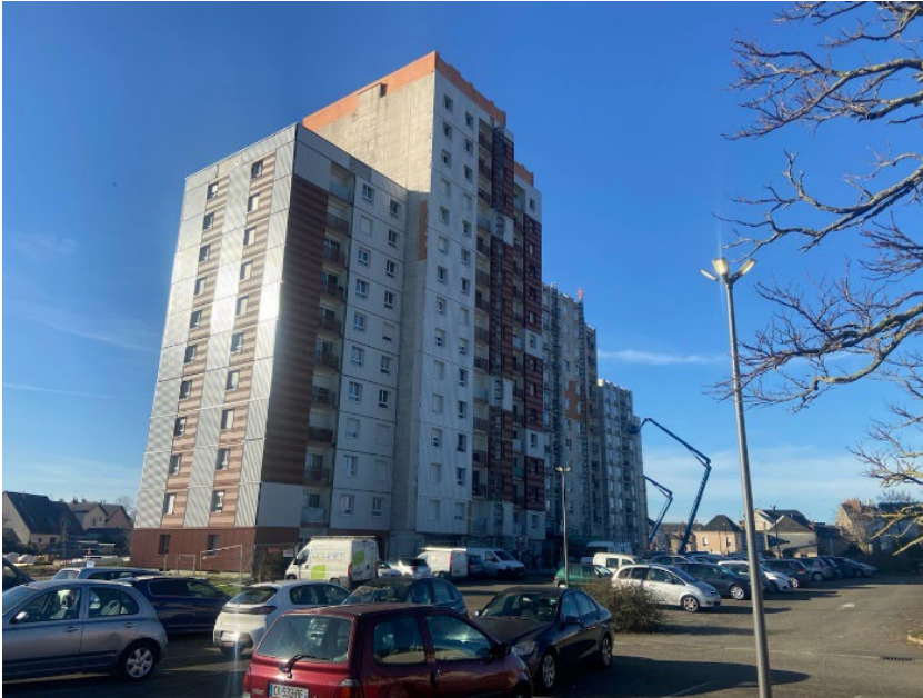
Les travaux sont en cours. Des FOB fabriquées hors site sont en cours de pose.
