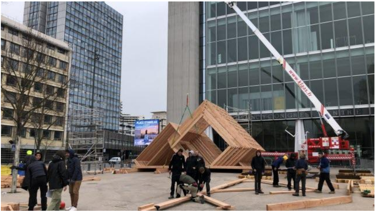
Les apprentis des Compagnons du Devoir montent la structure à plat avant de l'emboîter à la verticale. Photo ER /Julien BÉNÉTEAU
