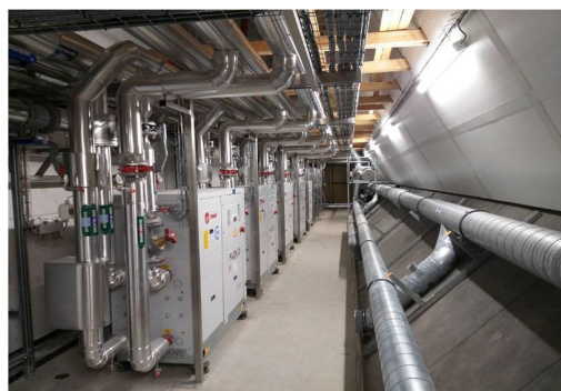
Galerie technique Basse PAC eau/eau en cascade. Ballons tampons eau chaude /froide
