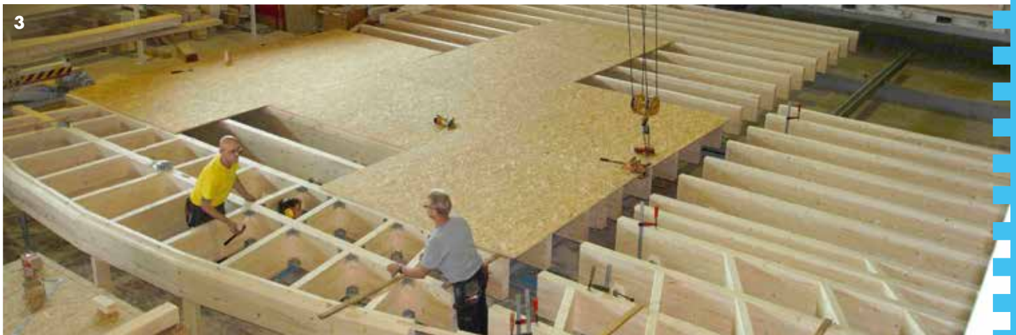
3 / Restaurant : Plancher d'étage de 40 cm de hauteur avec poutres de rive courbes et poutrelles ajourées sur tectofix 3000
